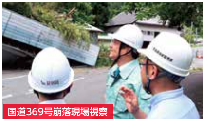
国道369号崩落現場視察
